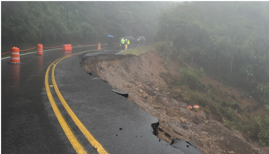
Problema: Instabilidade de Encostas
